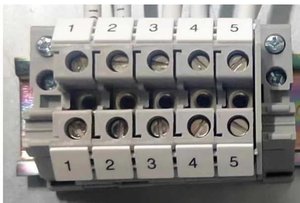
图 6-1 控制柜接线排
